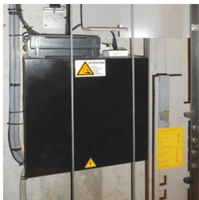
Nouveau coffret puissance en gaine
